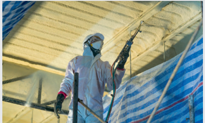
Isolation par l'intérieur avec de la mousse polyuréthane, obtenue après transformation du pétrole brut, projetée à l'aide d'un pistolet propulseur directement sur les murs et plafonds © Shutterstock
