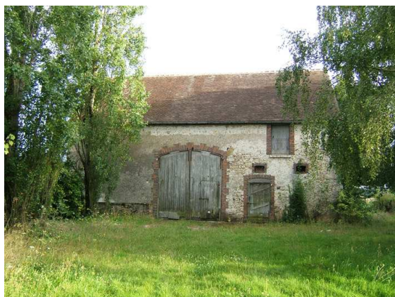
Etat avant travaux
