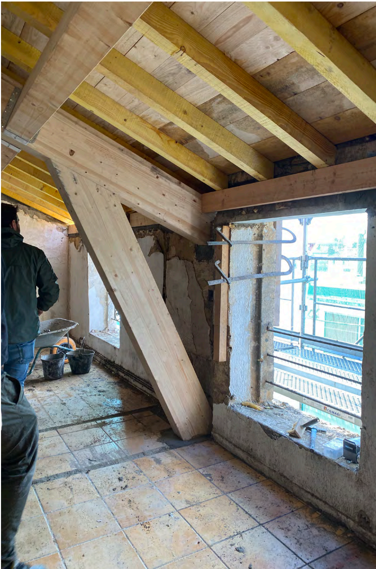
↗ Dépose et repose d'une nouvelle charpente et réalisation traditionnelle de zinguerie sur les corniches et chapiteaux.
