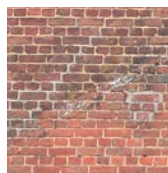
Briques à appareillage hollandais-anglais à joints épais Trace de lière
