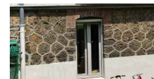
Références : Ravalement du mur en pierre et du couronnement en briques existants
